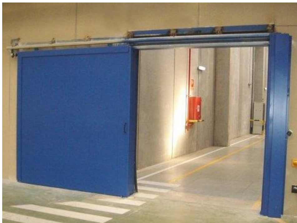
Figura 112 - Portão de correr resistente a fogo
